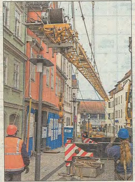
Gleich geschafft: Der Ausleger schwebt nur noch wenige Meter über dem Pflaster des Zinkenwehrs.
