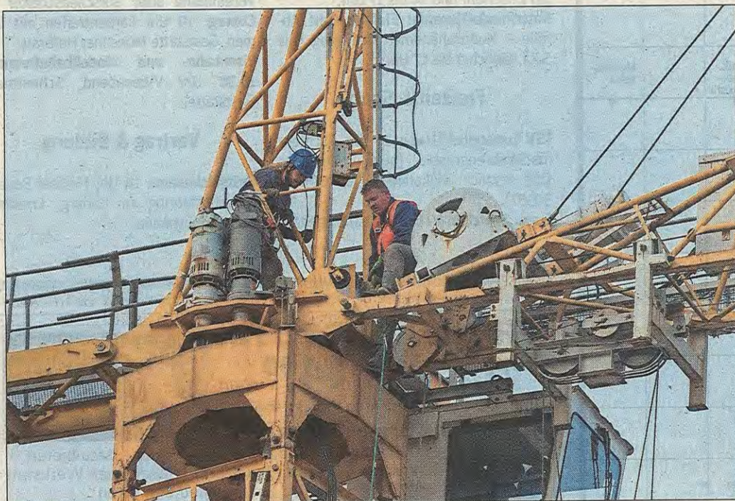
Schwerarbeit in luftiger Höhe: Bevor der Drehkran der Firma Pfister demontiert werden konnte, mussten die Bauteile vorsichtig auseinandergeschraubt werden.
